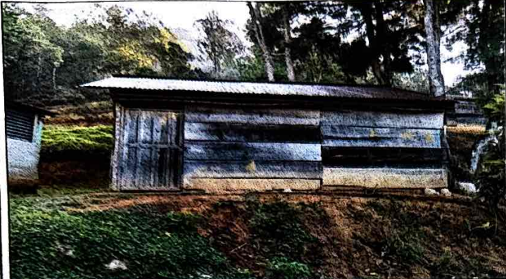
Foto 1: SUSTITUCION DE BODEGA POR ESTAR EN MAL ESTADO
