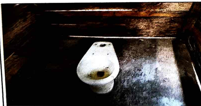
Foto 5: SUSTITUCIÓN DE INODORO POR DETERIORO
